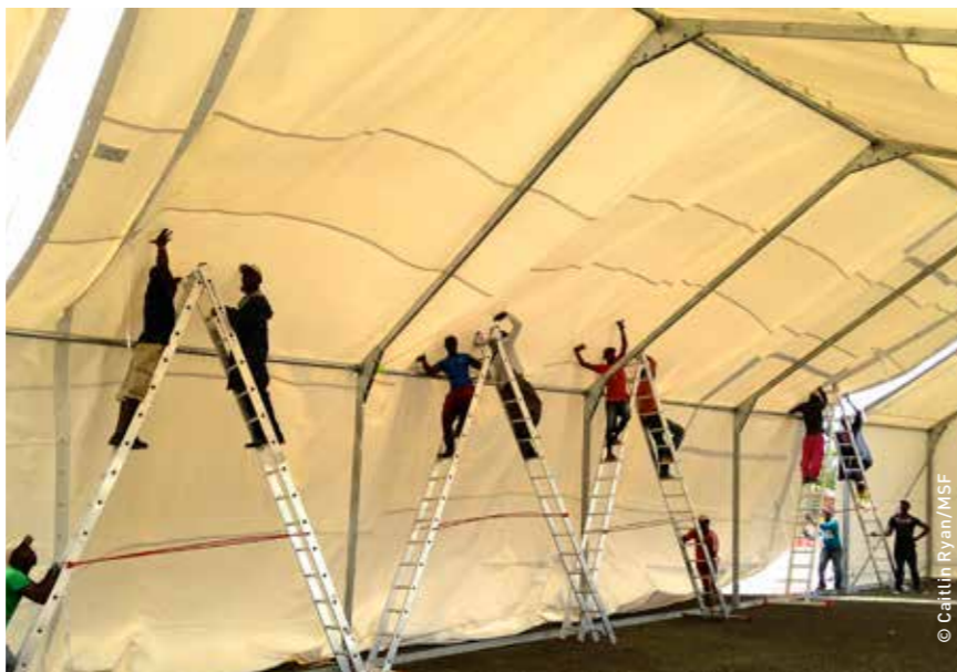
Monróvia, Libéria. Equipes de construção estruturando o que se tornaria o ELWA 3, o maior centro de tratamento de Ebola do mundo, com 250 leitos.
